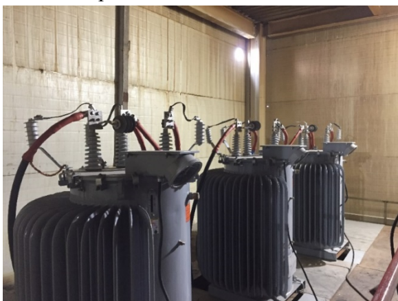
Рисунок 2 - На предприятии в Республике Мордовия два комплекта ПРН 10 кВ установлены на опорах ЛЭП в непосредственной близости от предприятия (рис. 5). Телемеханика организована с использованием беспроводной связи.
