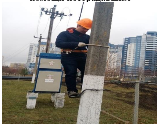
Мастер класс «Эксплуатация электрооборудования»
